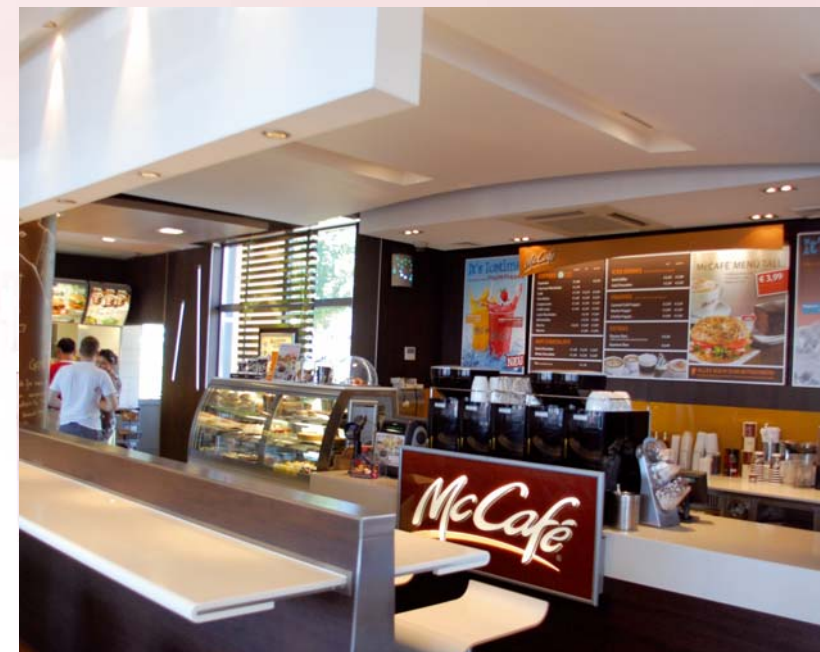
In 125 McDonalds-Restaurants in Mittel- und Süddeutschland war Hübner für die maßgeschneiderte Klimatechnik verantwortlich. In die neu errichteten McCafés wurden dezentrale Raumkühlanlagen eingebaut.
